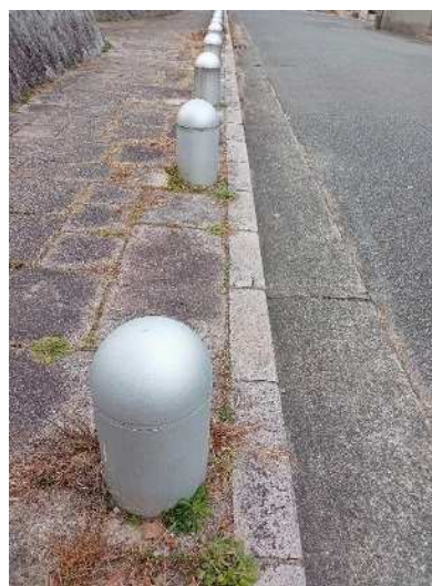
写真 2-2 コンクリート製基礎部隙間の草
