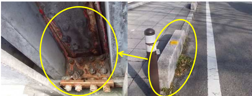
写真 4-9 橋面からの侵入水による鋼材腐食の事例
