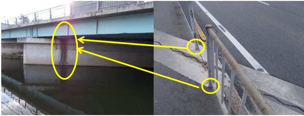
写真 4-11 防護柵が防水層を貫通した漏水の事例
