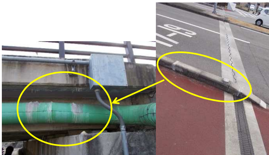
写真 4-10 橋面からの侵入水により遊離石灰化が生じた事例
